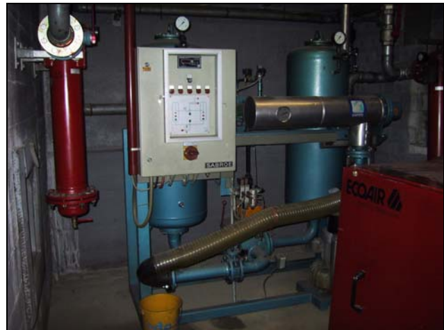
Abbildung 2.19: Adsorptionstrockner für die Trocknung der Druckluft im Winter (mit Druckverlust von ca. 1 bar)
