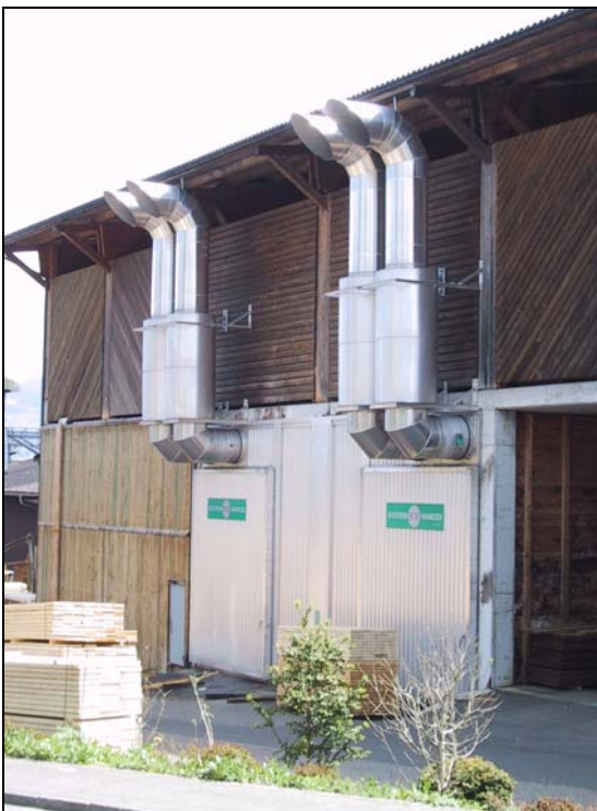
Abbildung 2.17: Zwei der insgesamt 11 Trockenkammern.
