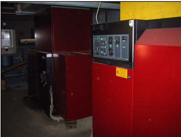
Abbildung 2.18: Druckluftkompressor 1 und 2. Antrieb pro Kompressor mit 75 kW Elektromotor.
