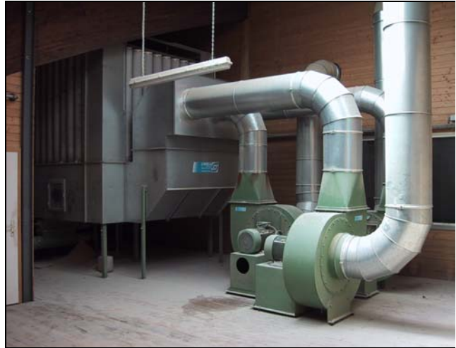
Abbildung 2.21: Absaugventilatoren und Filterstation bei Leimwerk 2.
