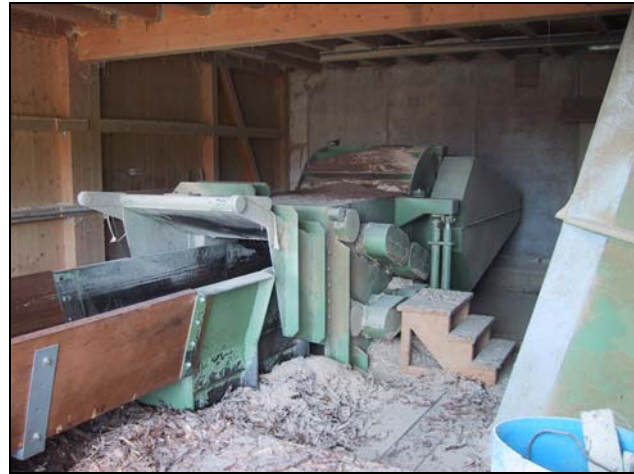
Abbildung 2.6: Über die Vibrarinne gelangt das Holz in den Einzug und danach in den Hacker. Der Hacker hat einen Antriebsmotor mit 200 kW.
