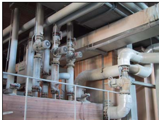
Abbildung 2.26: Die Wärmeverteilung erfolgt mit Haupt- und Zwischenpumpen.
