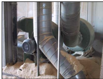
Verwinkelte und undichte Absauganlagen. Diese verursachen Stromkosten von Fr. 75'000.- pro Jahr.
