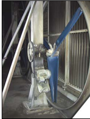
Ventilatoren in den Trockenkammern: Drehzahlregulierung spart 24% Energie.
