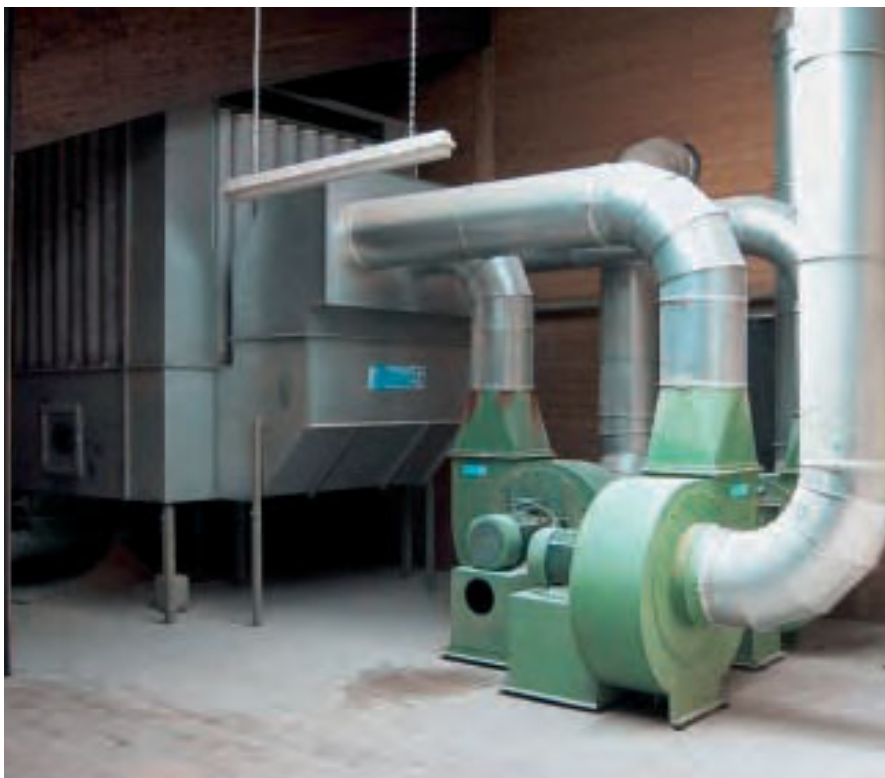
Gesamteinsparungen allein bei den Absauganlagen: 34 000 Franken pro Jahr.
