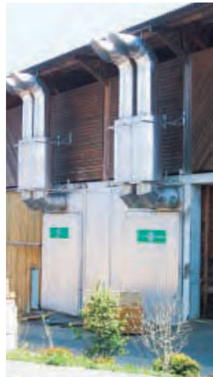
Vor allem die beiden Trockenkammern verbrauchen viel Energie.
