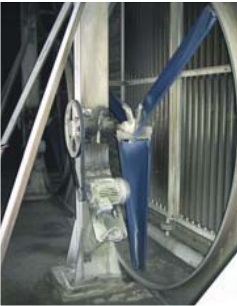
Ventilatoren in den Trockenkammern: Drehzahlregulierung spart 24% Energie.
