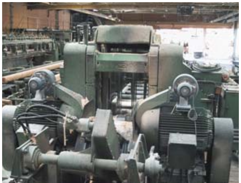
Motoren laufen häufig im Leerlauf. Ein bedarfsabhängiges Schalten lohnt sich.
