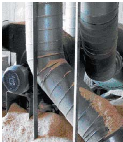
Verwinkelte und undichte Absaug-anlagen. Diese verursachen Strom-kosten von 75 000 Fr. pro Jahr.
