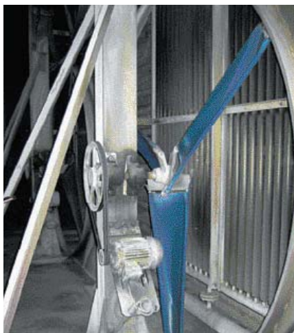
Ventilatoren in den Trocknungskammern: Drehzahlregulierung spart 24% Energie.
