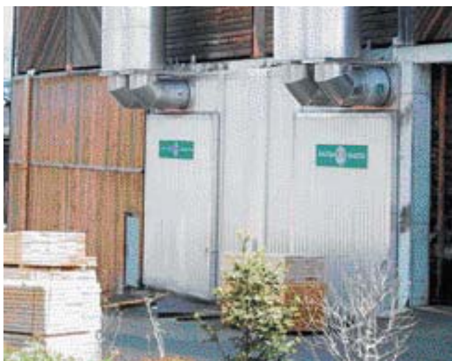
Die Trocknungskammern verbrauchen viel Energie.
