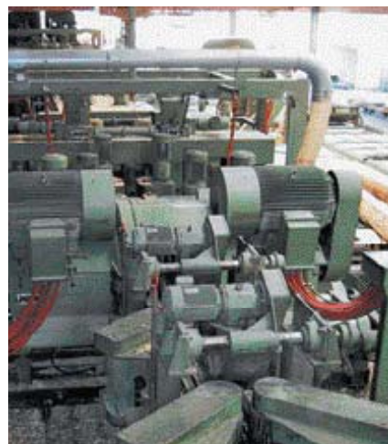
Motoren laufen häufig im Leerlauf. Ein bedarfsabhängiges Schalten lohnt sich.
