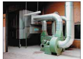
Gesamteinsparungen bei den Absauganlagen: Fr. 34 000.- pro Jahr.
