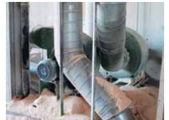
Verwinkelte und undichte Absauganlagen. Diese verursachen Stromkosten von Fr. 75 000.- pro Jahr.
