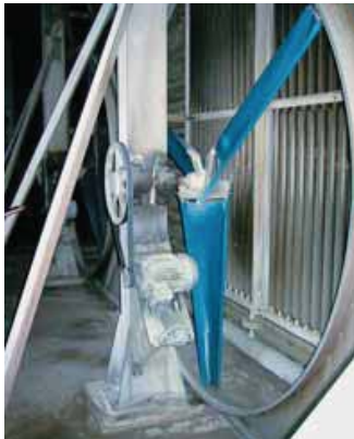
Ventilatoren in den Trockenkammern: Drehzahlregulierung spart 24% Energie.
